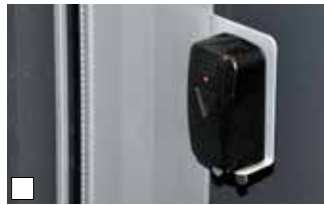
Lichtschanke unten zur Durchfahrtsicherung
